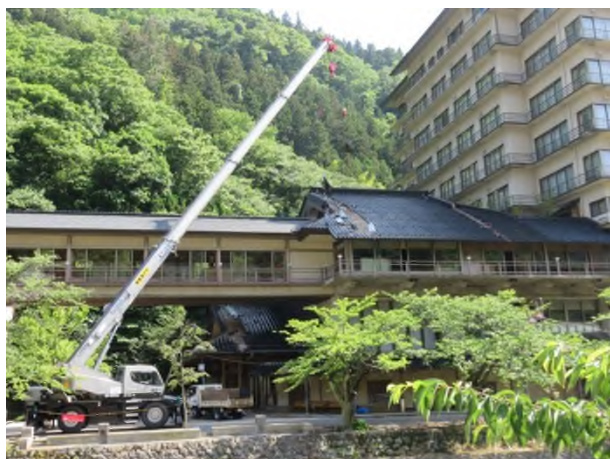
図 2-11 あつみ温泉の老舗旅館の建物の屋根瓦の被害
