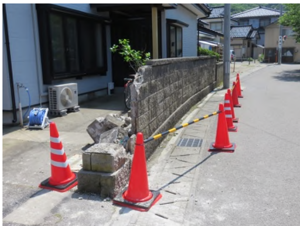
図 2-20 組積造（大谷石）の塀の一部崩壊
