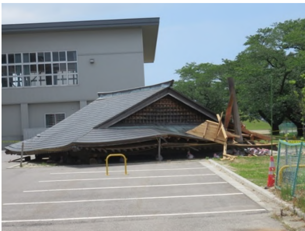
図 2-28 鶴大泉小学校の相撲場の屋根の崩壊
