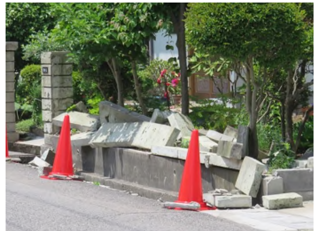
図 2 - 30 組積造の塀の倒壊
