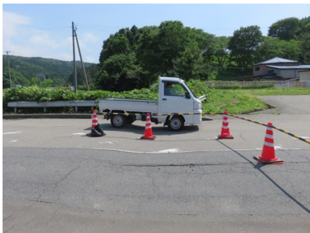
図 2-14 道路のへこみと亀裂 バリケードがあり、通行は限定されている。 へこみの部分は速度を落として走行している。
