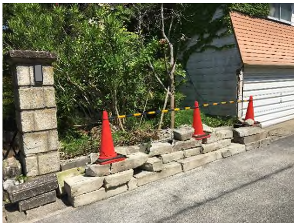
図2-33 組積造の塀の倒壊
