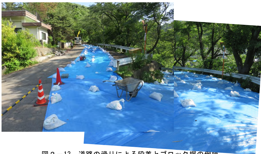
図 2-13 道路の滑りによる段差とブロック塀の倒壊 道路の盛土部の亀裂が広がらないようにブルーシートで覆う。 左上の建物の前面道路には崩壊したブロック塀が積まれている
