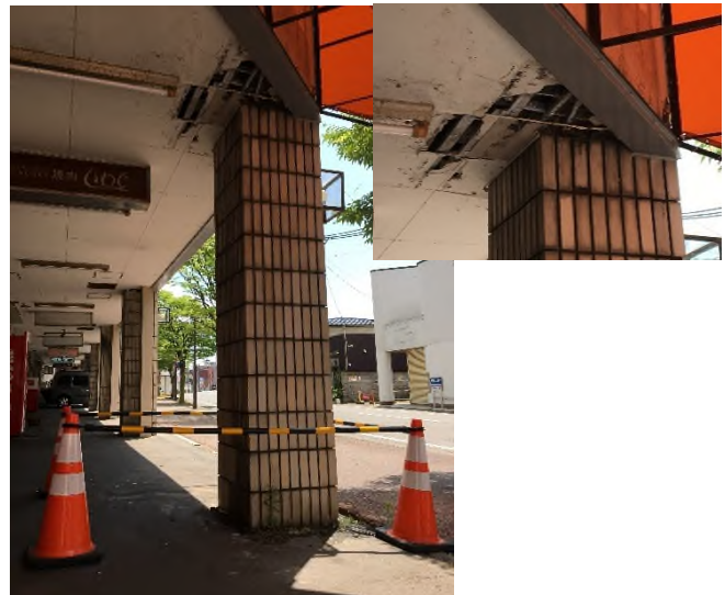
図 2-27 鶴岡駅前ビルのピロティ柱上部の被害
