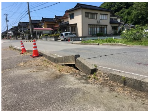
図 2-15 道路のへこみと亀裂。 圧縮力による歩車道境界ブロックの浮き上がり。
