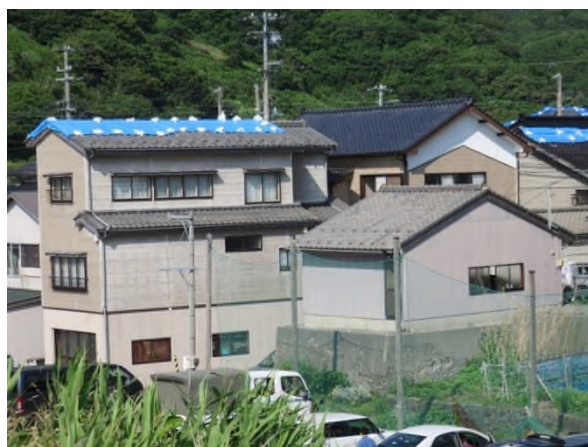
図 2-7 小岩川地区の民家の屋根瓦の被害 19日に調査したときはシートが被されていないかった（図 2-6）が、20日に調査したときはシートが被されていた
