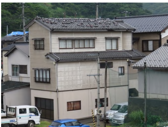
図 2-6 小岩川地区の民家の屋根瓦の被害（6月19日調査）
