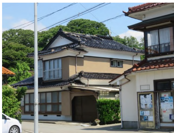
図 2-17 屋根瓦の被害
