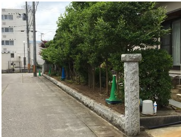
図 2 - 29 組積造の塀の倒壊
