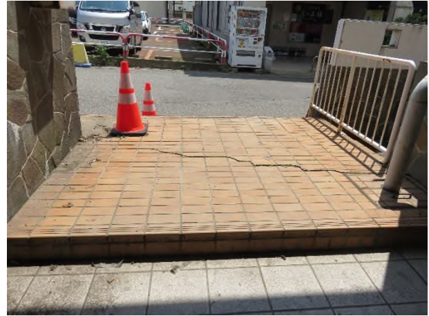
図 2-25 鶴岡駅前通路のひび割れ段差
