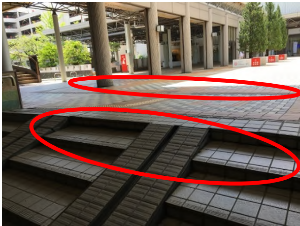
図 2-24 鶴岡駅地下通路の階段前後の沈下
