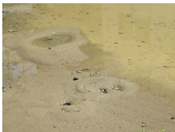
図 2-23 鶴岡駅前空き地の液状化発生地点 液状化による噴砂孔
