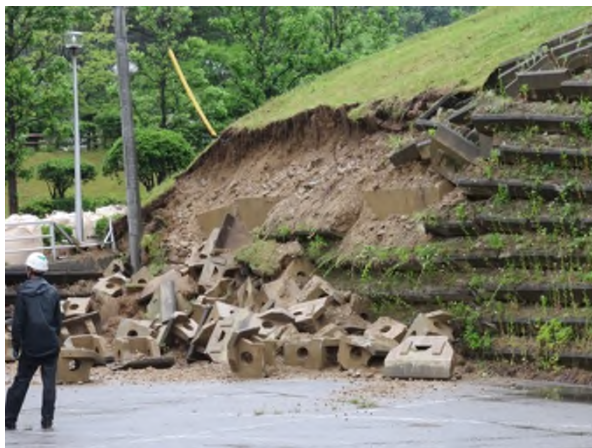
図2-2 村上市府屋にある総合体育館敷地内の盛土法面の崩壊地
