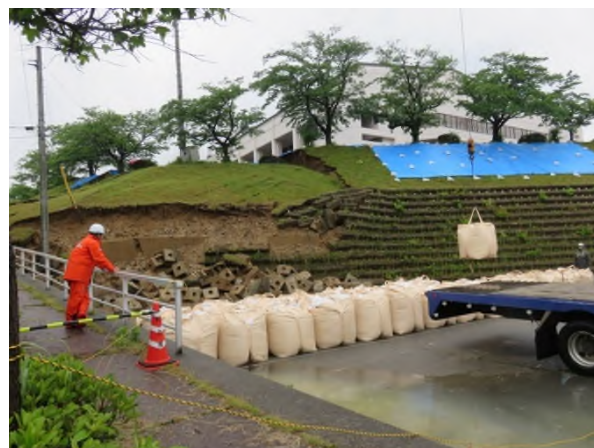
図2-3 村上市府屋にある総合体育館敷地内の盛土法面の崩壊の全景
