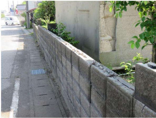
図2-32 コンクリートブロックの倒壊
