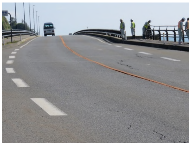
図 2-10 国道 7 号線の橋梁取り付け盛土の沈下と亀裂
