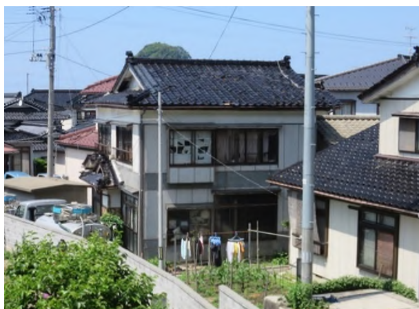
図 2-16 屋根瓦の被害
