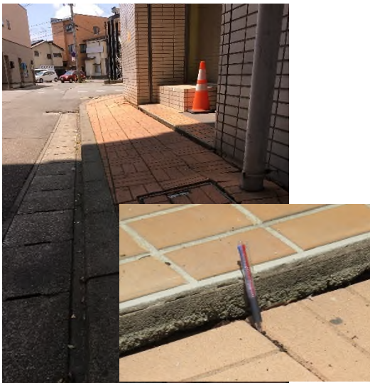
図 2-26 鶴岡駅前のビル前の段差 段差は、約 10cm
