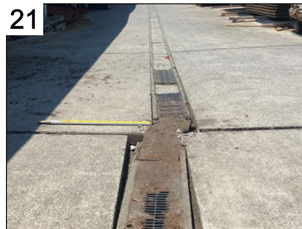
宇城市豊野町下郷の右横ずれ変位したグレーチング 7) 。右横ずれ変位量は約24cm。8月2日撮影。
