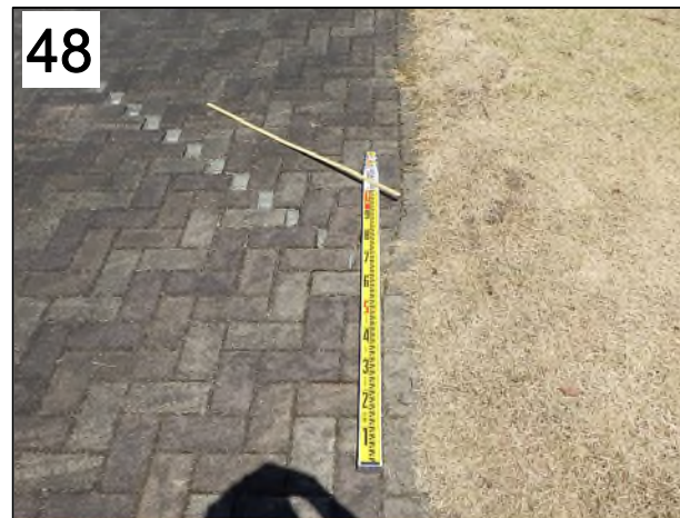
氷川町大野の歩道のタイルの右横ずれ。変位量は9cm。8月5日撮影。
