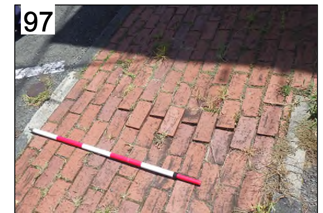
八代市平山新町のタイルの損壊。明瞭な横ずれおよび縦 ずれ変位は認められないが、開口部付近のタイルがわず かに左回転しているように見える。8月4日撮影。
