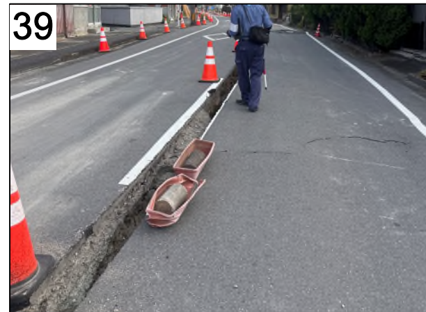
宇城市小川町西北小川の車道を縦断する地震断層、縦ずれ約25cm（写真左の東側隆起）、8月6日撮影。
