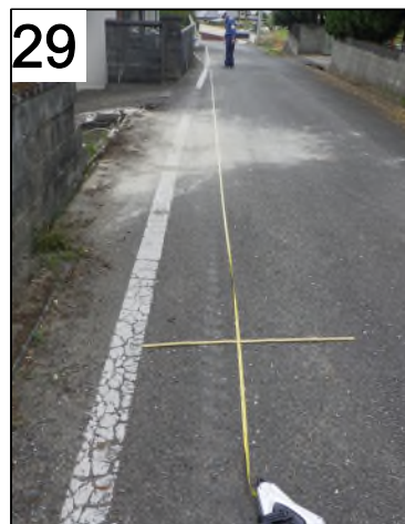
宇城市小川町南小野の道路の右横ずれ. 変位量は43cm. 縦ずれは不明瞭. 8月7日撮影.
