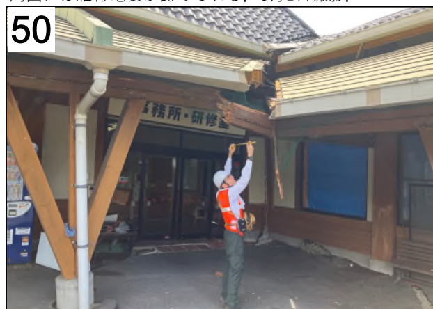
断層変位によって破断した氷川町道の駅「竜北」の屋根 7) 。写真右の西側が低下している。水平変位量は約30cm、上下変位量は約35cm。8月1日撮影。
