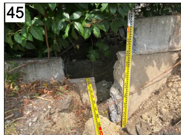
45 氷川町吉本のブロック塀の右横ずれと縦ずれ変位 7) 。右横ずれ約40cm、縦ずれ約37cm（写真右の東側隆起）であり、縦ずれと横ずれ変位同程度認められる。8月1日撮影。
