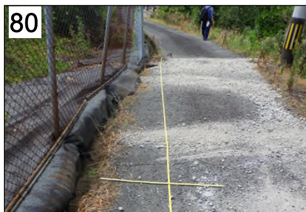
八代市東片町の車道を横切る地震断層。右横ずれ57cm, 縦ずれ34cm（写真手前の東側隆起）。8月6日撮影。
