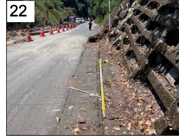
宇城市小川町中小野の娑婆神峠で県道244号を横切る地震断層 7) 。道路白線や側溝の右横ずれ変位量は約73cmであり、上下変位量は不明瞭。8月2日撮影。
