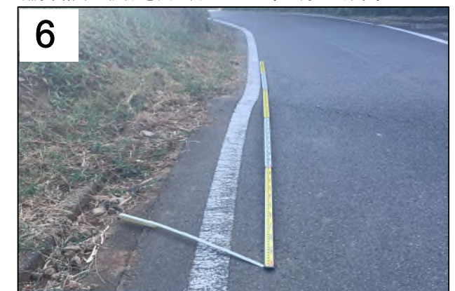
御船町高木の道路白線の右横ずれ 7) 。写真手前の東側が相対的に低下する。2016年地震とその後の余効すべりにより本地震の以前から変位が認められていたが、本地震でも再び変位した。舗装路面に雁行亀裂が認められる。8月2日撮影。
