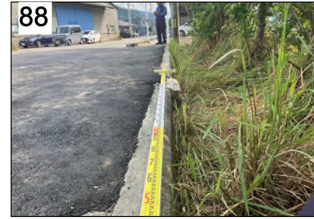
八代市豊原下町の道路の右横ずれ 7) 。道路白線および縁石が約5cm右横ずれする。上下変位は小さく不明瞭。8月3日撮影。
