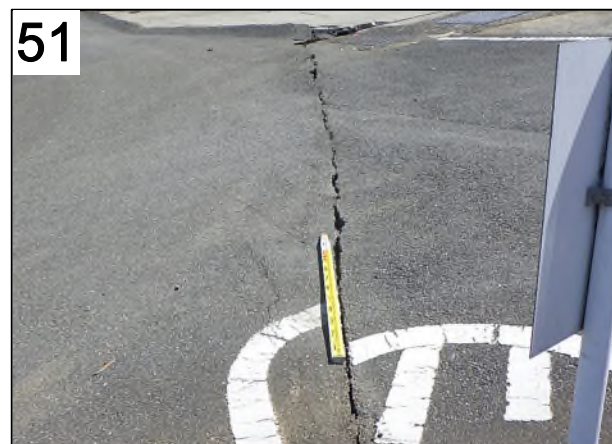
氷川町大野の車道を横切る地震断層。右横ずれ38cm。8月5日撮影。
