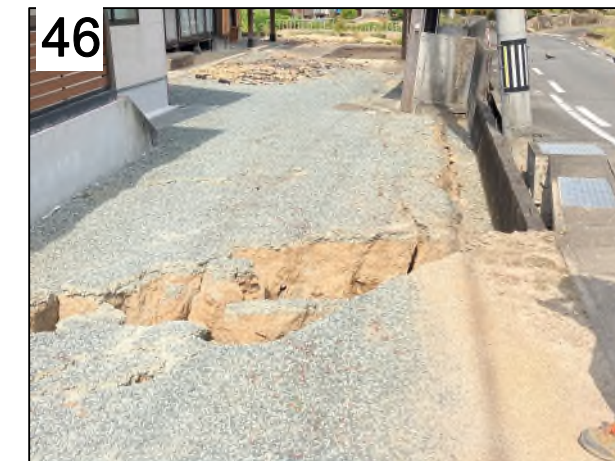
46 氷川町吉本の民家にあらわれた開口亀裂 7) 。縦ずれ変位が顕著であり、縦ずれ約70cm（写真右の南東側隆起）。8月1日撮影。
