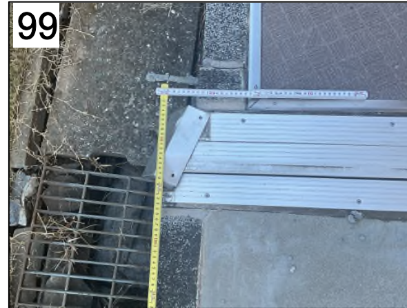
八代市平山新町の熊本高等専門学校八代キャンパス図書館横の側溝の変状。右横ずれ7cm、縦ずれ1cm（南西上がり）。図書館建屋を挟んで、3～4条の地震断層が雁行状に配列する。8月18日撮影。
