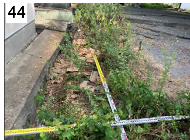
44 氷川町吉本の住宅地にあらわれた地震断層 7) 。右横ずれ約50cm、縦ずれ約54cm（写真奥の東側隆起）であり、縦ずれ変位と横ずれ変位が同程度認められる。8月1日撮影。
