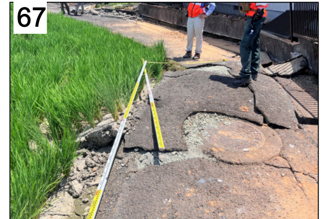
氷川町宮原の道路を横切る地震断層 7) 。右横ずれ約81cm。写真左の水田にかけて雁行状の亀裂が認められる。8月1日撮影。
