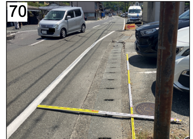
氷川町宮原の国道443号を横切る地震断層 7) 。道路白線や側溝が約147cmの右横ずれ変位を示す。8月1日撮影。
