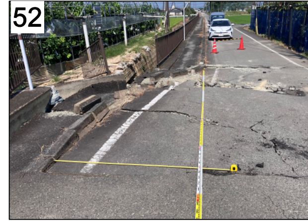
氷川町野津の車道を横切る地震断層。右横ずれ175cm、縦ずれ44cm（写真手前の東側隆起）。8月5日撮影。
