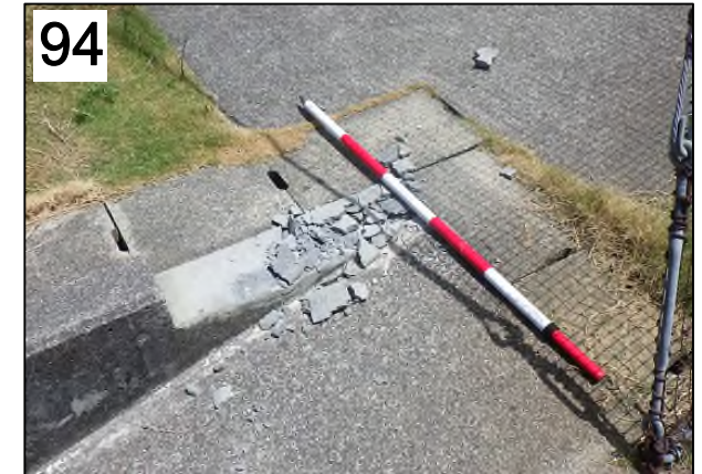
八代市平山新町の歩道コンクリートの損壊。 明瞭な横ずれおよび縦ずれ変位は認められない。 8月4日撮影。
