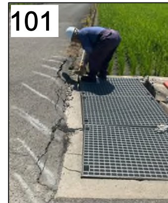
八代市平山新町の農業用水路の集水柵の損傷。柵蓋グレーリングが右横ずれ変位により左回転しながら“逆くの字”に折れ曲がる。8月18日撮影。
