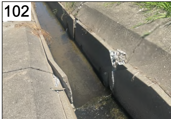
八代市平山新町の農業用水路の変状（右横ずれ1.5cm）。この他にも複数箇所でU字溝の圧縮変形が認められる。写真奥約250mに熊本高等専門学校八代キャンパスの野球場がある。8月18日撮影。
