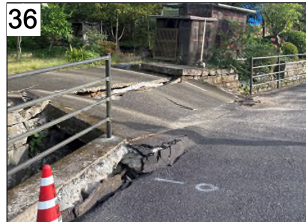
宇城市小川町西北小川、数十cmの右横ずれ変位により、用水路を横断する橋が損壊している、8月6日撮影。
