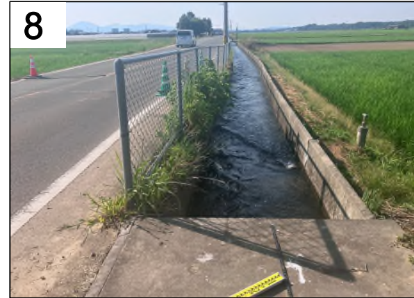
御船町滝川のフェンスの右横ずれ 7) 。2016年地震とその後余効すべりにより、本地震の以前から屈曲していたが、本地震でも再び変位した。累積変位は105 cm、舗装路面の雁行亀裂とフェンスの屈曲が認められる。8月2日撮影。
