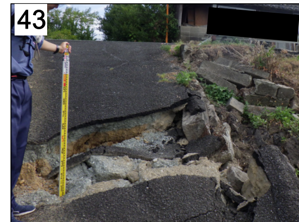
43 宇城市小川町小川の車道を横切る地震断層。右横ずれ、縦ずれともに数十cm（写真奥の東側隆起）。8月6日撮影。
