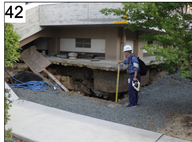
42 宇城市小川町小川の寺院を横切る地震断層。108cmの縦ずれ変位（写真奥の東側隆起）により、社殿の基礎が浮き上がっている。8月6日撮影。
