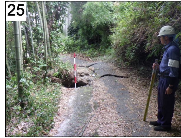
宇城市小川町南小野の道路を横切る地震断層。右横ずれ約40cm, 縦ずれ数十cm (写真手前の東側隆起)。8月7日撮影。
