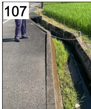
107 八代市催合町における道路脇の水路の変状。田んぼ側のコンクリート壁が内側に折れ曲がる。この周辺には、道路構造物の圧縮変形によると思われる損傷が目立つが、路面の亀裂や地割れは確認できない。8月18日撮影。
