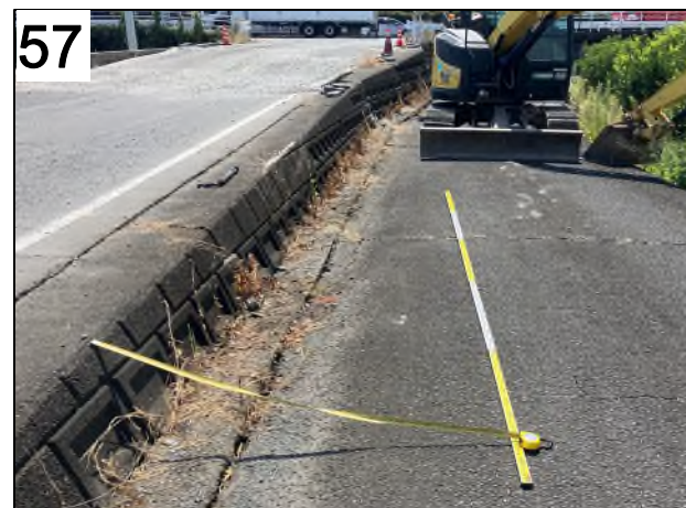
57 氷川町野津の道路の右横ずれ 7) 。右横ずれ約146cm, 縦ずれ約42cm (写真奥の東側隆起)。道路舗装には雁行 亀裂が認められる。8月1日撮影。
