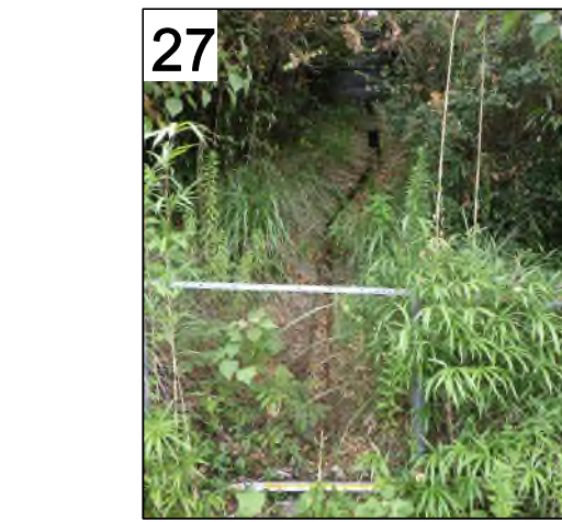
宇城市小川町南小野のU字溝の右横ずれ。変位量は約100cm。8月7日撮影。
