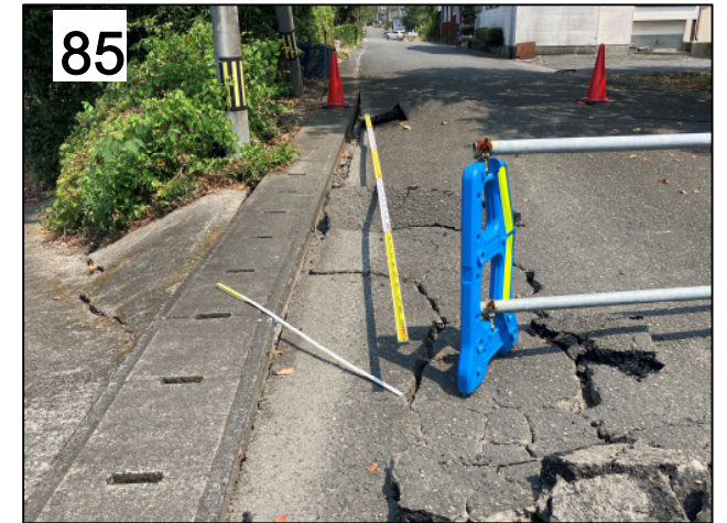
八代市古麓町の道路にあらわれた地震断層 7) 。 道路脇の側溝を基準として約76cm右横ずれしている。 上下変位は不明瞭。8月3日撮影。
