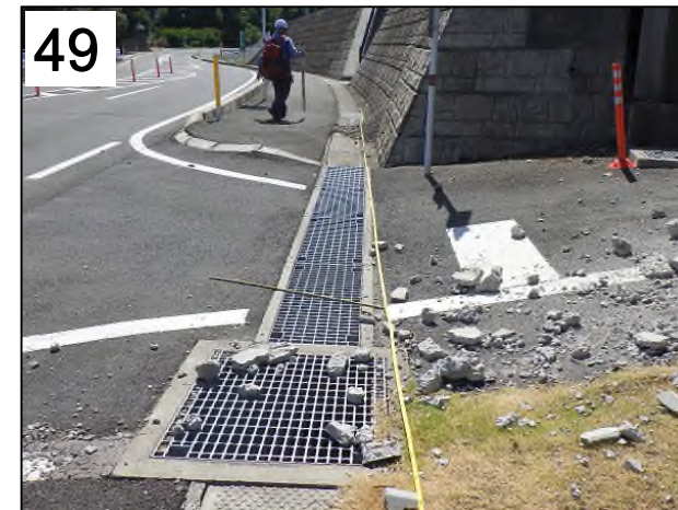
氷川町大野のグレーチングの右横ずれ。変位量は6cm。8月5日撮影。
