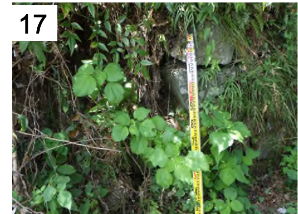
宇城市豊野町安見。石垣には10cm程度の右横ずれ変位を示す。8月7日撮影。
