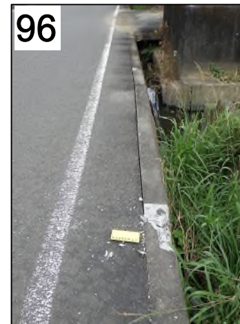
八代市平山新町の道路ブロックの損壊。 ブロックには約1cmの右横ずれ変位が認められるが、 車道には明瞭な変位は認められない。8月4日撮影。
