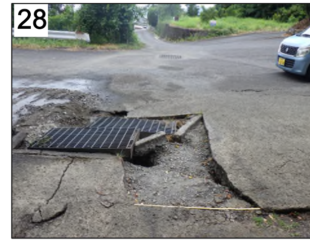
宇城市小川町南小野の道路を横切る地震断層。右横ずれ1.0m。8月7日撮影。
