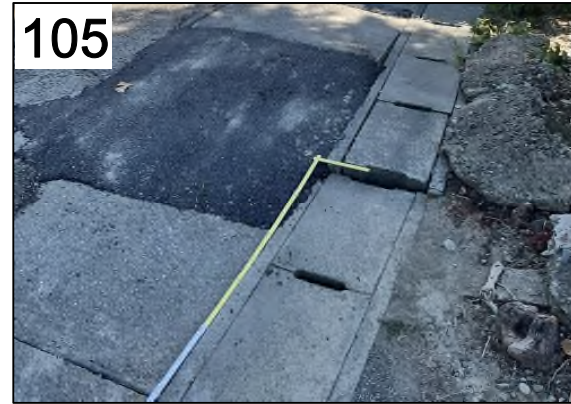
105 八代市場町の“夫婦楠”背後の道路側溝の変状。 路面は補修されており亀裂は確認できないが、側溝には右横ずれ4cm、縦ずれ1.5cm（南西上がり）の変位が認められる。明確な変位量の計測が可能な変状箇所の最南端に位置する。8月18日撮影。
