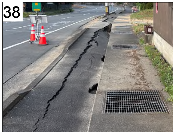
宇城市小川町西北小川、縦ずれ変位（写真右の東側隆起）により歩道にクラックが生じている、8月6日撮影。
