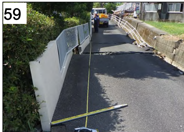
氷川町野津の車道を横切る地震断層。右横ずれ52cm, 縦ずれ57cm (写真手前の東側隆起)。8月5日撮影。
