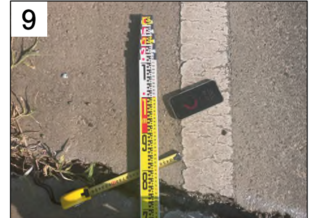
御船町滝川の道路白線の右横ずれ 7) 。写真8と同地点であり、舗装路面の亀裂が新鮮であることから、本地震による約7cmの右横ずれ変位と考えられる。舗装路面の破壊が認められる。8月2日撮影。
