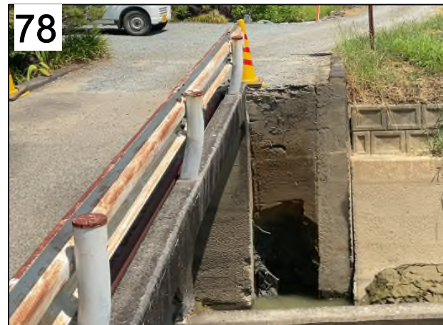
八代市川田町西の新川（国営不知火幹線水路）を横断する橋梁アバットが地震断層による変位で120cm右横ずれしている。8月1日撮影
