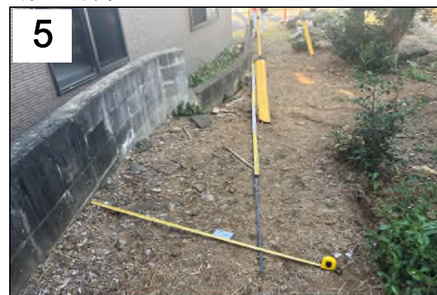
御船町高木のブロック塀の右横ずれ 7) 。2016年地震とその後の余効すべりにより本地震の以前から80 cm以上屈曲していたが、本地震でも再び変位した。累積変位は117cm。雁行亀裂と塀の破壊が認められる。8月2日撮影。
