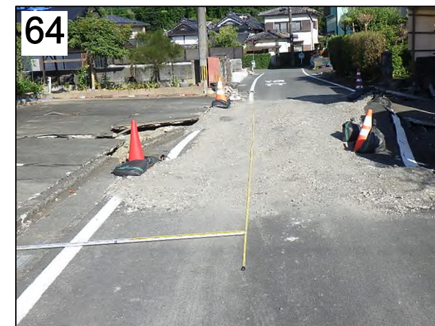
氷川町野津の車道を横切る地震断層。右横ずれ141cm, 縦ずれ13cm (写真奥の東側隆起)。8月5日撮影。
