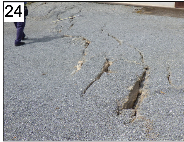
宇城市小川町南小野の民家の敷地を横切る地震断層。右横ずれ80cm, 縦ずれ31cm (写真奥の西側隆起) であり、雁行状にクラックが発達する。8月7日撮影。
