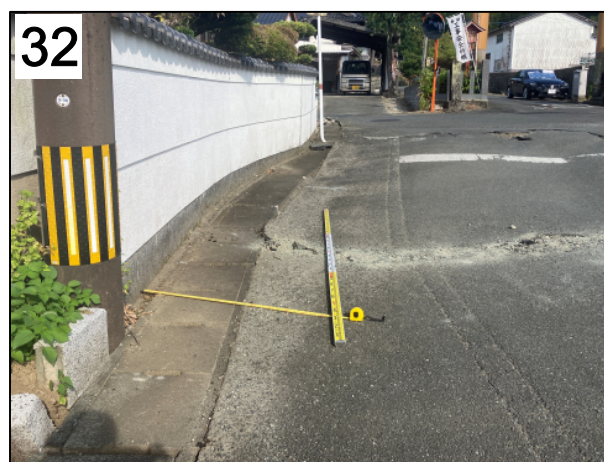
宇城市小川町南部田の側溝ブロックや白壁の右横ずれ 7) . 横ずれ変位は約116cmであり, 上下変位は小さい. 舗装路面には雁行亀裂が認められる. 8月1日撮影.
