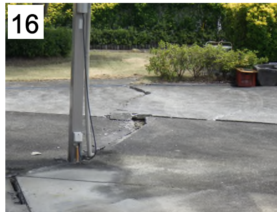
宇城市豊野町安見の宅地を横切る地震断層。N69E方向に伸長し、約10cmの右横ずれ変位を示す。8月7日撮影。
