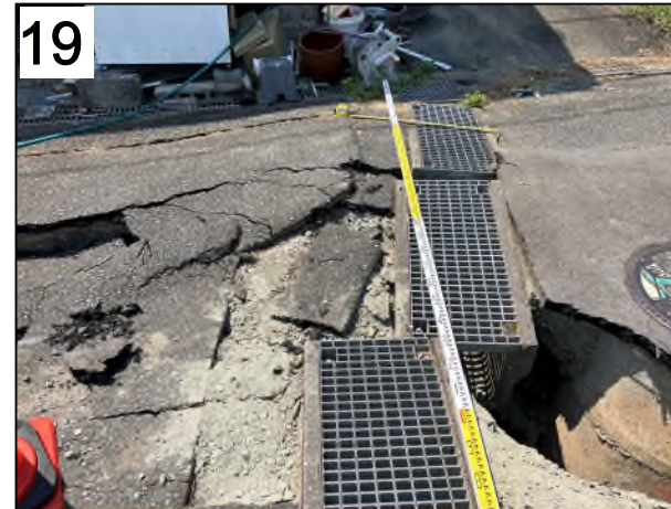
宇城市豊野町下郷の道路を横切る地震断層 7) 。グレーチングの右横ずれ変位量は約63cm。写真奥の西側が約15cm隆起する。8月2日撮影。
