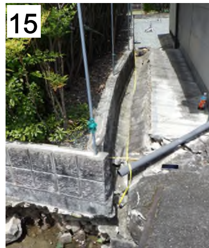
宇城市豊野町安見のブロック塀の右横ずれ。変位量は横ずれ18cm、縦ずれ数cm（写真奥の西側隆起）。8月7日撮影。
