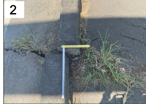
御船町高木の道路脇の縁石の右横ずれ。右横ずれ変位量は約10cmであり、わずかな上下変位が認められる。アスファルト路面には雁行状の亀裂群が認められる。8月19日撮影。
