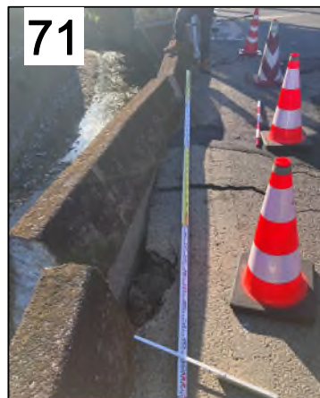
氷川町柵の護岸壁の右横ずれ 7) 。 道路には雁行亀裂が認められ、やや写真手前の東側が隆起。 7月31日撮影。
