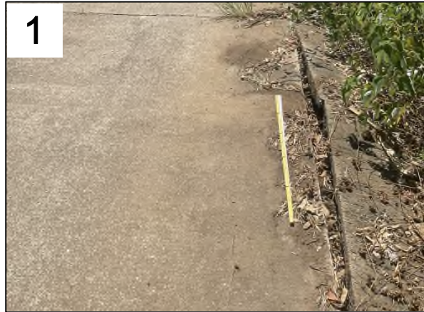
益城町小池の舗装路面の変状。本地震であらわれた地震断層の北端と考えられる。周辺の地表面には杉型雁行亀裂が認められる。8月19日撮影。
