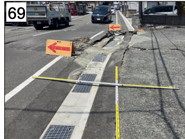
氷川町宮原の国道443号を横切る地震断層 7) 。横ずれ約186cm。断層帯の広い範囲で変位し、雁行亀裂が認められる。断層帯周辺がやや隆起する。8月1日撮影。
