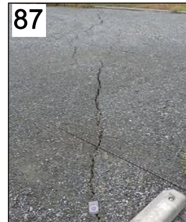
八代市豊原下町の駐車を横切る地震断層。わずかに右横ずれしている。8月4日撮影。
