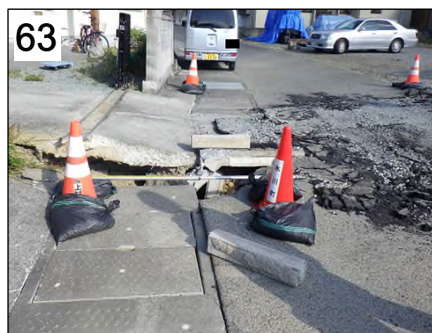
氷川町野津の車道を横切る地震断層。右横ずれ118cm, 縦ずれ15cm (写真奥の東側隆起)。8月5日撮影。
