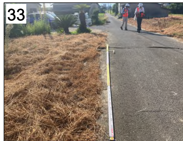
宇城市小川町南部田の道路の右横ずれ 7) . 道路舗装を基準として, 約20cmの右横ずれ変位を示す. 写真奥の西側がやや低下する. 8月1日撮影.
