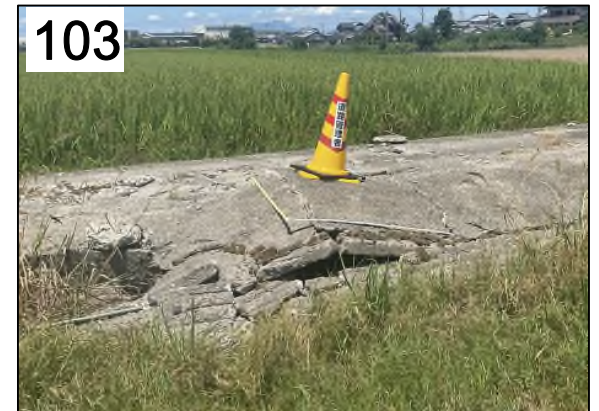
八代市平山新町の農道コンクリート張りの変状。この周辺では、圧縮変形によるコンクリートの損傷が目立つ。8月18日撮影。
