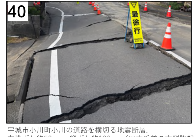
宇城市小川町小川の道路を横切る地震断層、右横ずれ約50cm、縦ずれ約100cm（写真手前の東側隆起）であり、路面には複数のクラックが発達している。この地点付近において、地震断層の局所的な走向が北北東から北東方向へと湾曲する、8月6日撮影。
