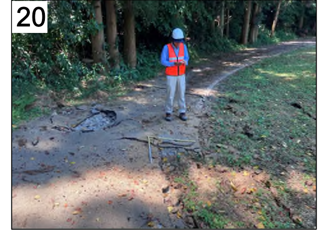
宇城市豊野町下郷の道路を横切る地震断層 7) 。道路舗装の右横ずれ変位量は約73cm。未舗装の地表面に雁行状の亀裂群が認められる。8月2日撮影。
