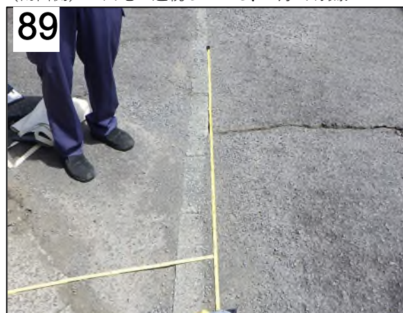
八代市豊原下町の車道を横切る地震断層。右横ずれ4cm。8月4日撮影。
