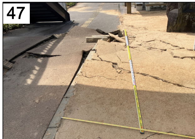
氷川町道の駅「竜北」にあらわれた地震断層 7) 。舗装路面を基準として約91cmの右横ずれ変位が認められる。縦ずれ変位は数cm程度。周囲には雁行亀裂が認められる。8月1日撮影。
