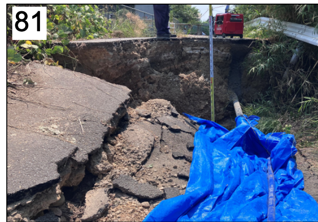
八代市上片町の九州自動車道八代ジャンクション付近の道路を横切る地震断層 7) 。上下変位が顕著であり、変位量は約175cm（写真奥の南東側隆起）。8月3日撮影。
