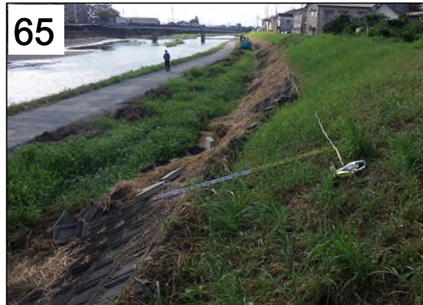
氷川町野津の氷川堰堤を横切る地震断層 7) 。右横ずれ141cm。8月5日撮影。
