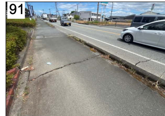
八代市平山新町の道路を横切る地割れ。地割れは幅約5cmで開口し，明瞭な横ずれおよび縦ずれ変位は認められない。8月4日撮影。
