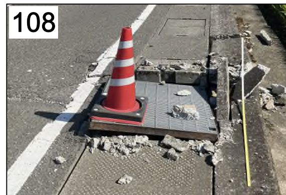
108 八代市催合町における道路側溝グレーチングの浮き上がり とコンクリート集水枠の損傷。周辺では、鋼、コンクリート、アスファルトなどの異なる材質の連結部で損傷が大きい。変位を伴う路面の亀裂・地割れは確認できない。8月18日撮影。
