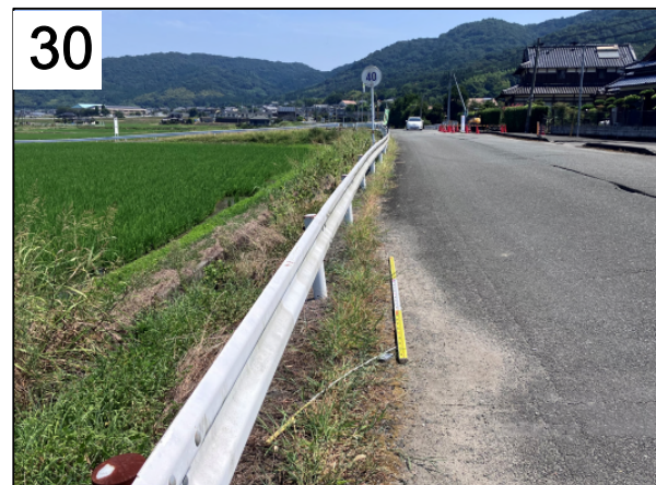
宇城市小川町北部田のガードレールの右横ずれ. 幅広く変形が認められ, 右横ずれ95cm. 道路には雁行状の亀裂が認められる. 8月2日撮影.
