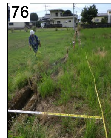
八代市川田町東の水田を横切る地震断層。 右横ずれ123cm、縦ずれ51cm（写真手前の東側隆起）。 8月6日撮影。
