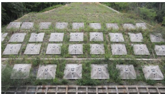
グラウンドアンカー
