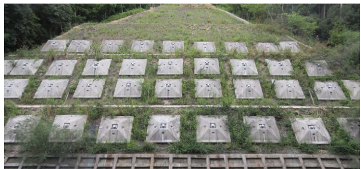
グラウンドアンカー
