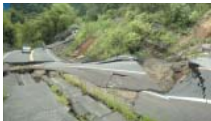
新潟県中越沖地震の被害事例
