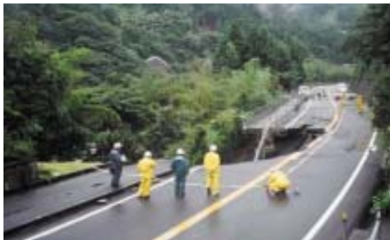
台風による四国地方の道路災害
