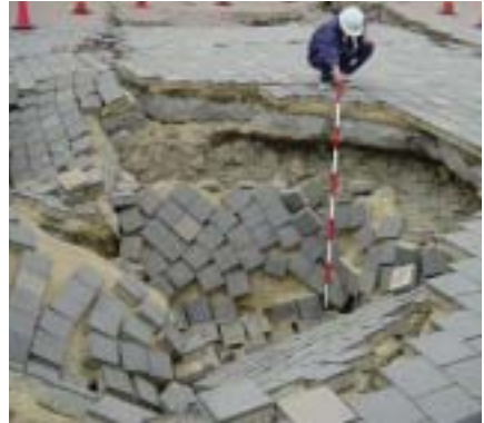
福岡県西方沖地震の被害調査
