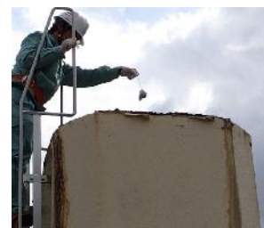
煙突上部からのカメラ診断
