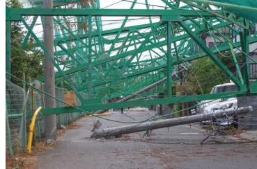
2019年9月 台風15号による被害状況（千葉県での電柱などの倒壊）
