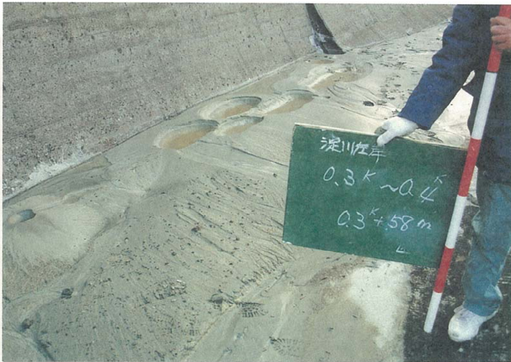
写真-1 地表からの噴砂の状況
