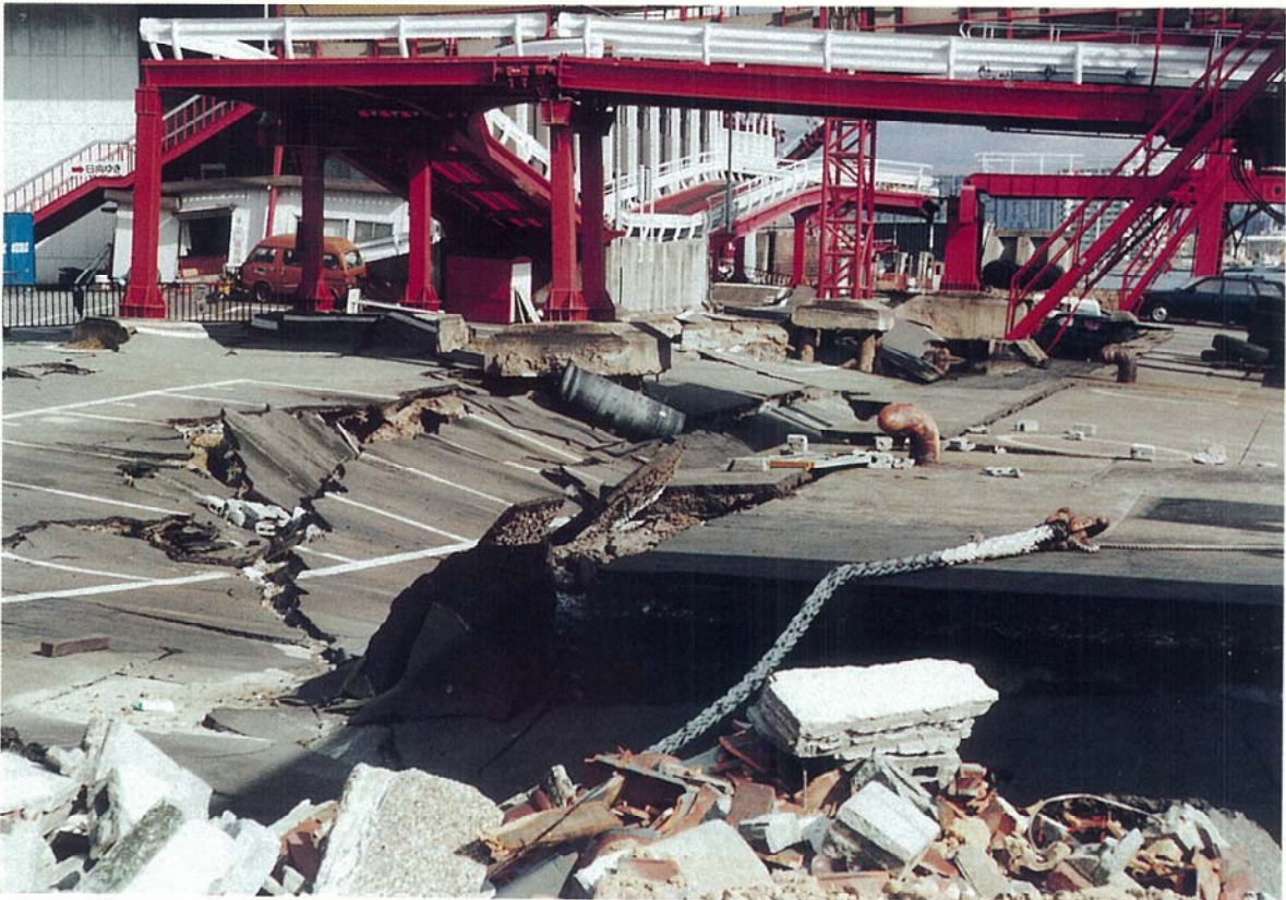
神戸市東灘区、神戸フェリーセンターでの液状化による岸壁の沈下状況。
