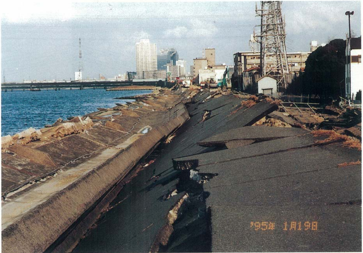
大阪市此花区、淀川左岸での液状化による堤防の沈下状況。
