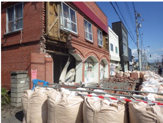
安平町 外壁レンガの剥落
