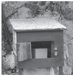
地震計保護箱設置状況 Seismograph cover box setting
