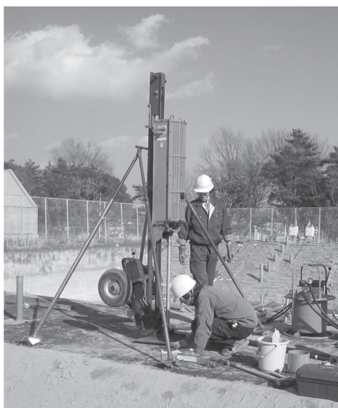
写真-1 観測井設置作業中のオートマチックラムサウンディング装置
