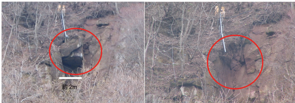
写真-7 D地区で崩壊した岩塊（左側が崩壊前、右側が崩壊後）
