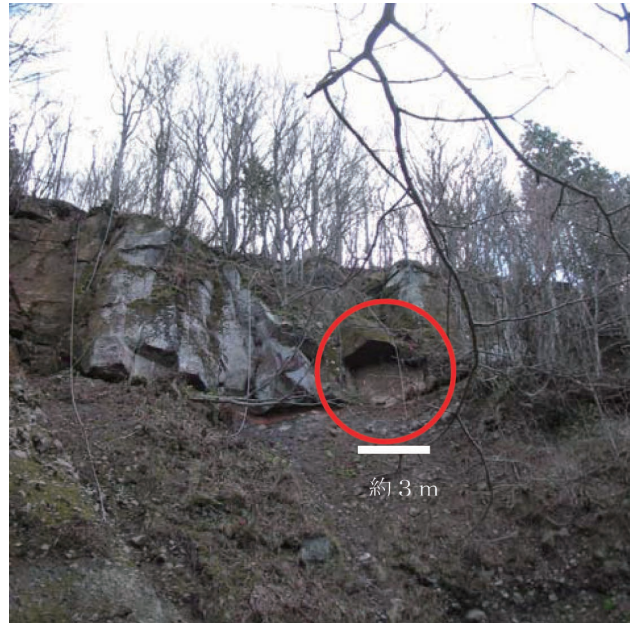
写真-8 落石前兆現象を捉えられなかった落石跡
