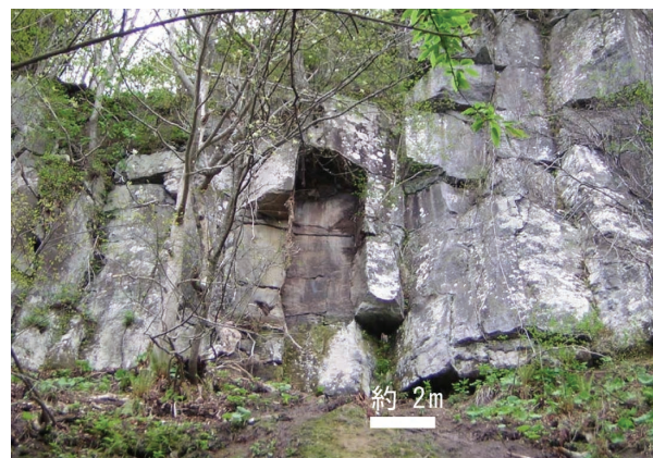
写真-2 E地区 オーバーハング部 Photo 2 Over hanged slope in E area
