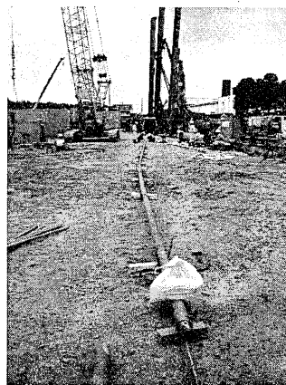
写真-1 管路設置状況 (パターンB) Photo.1 Casing installation (pattern B).
