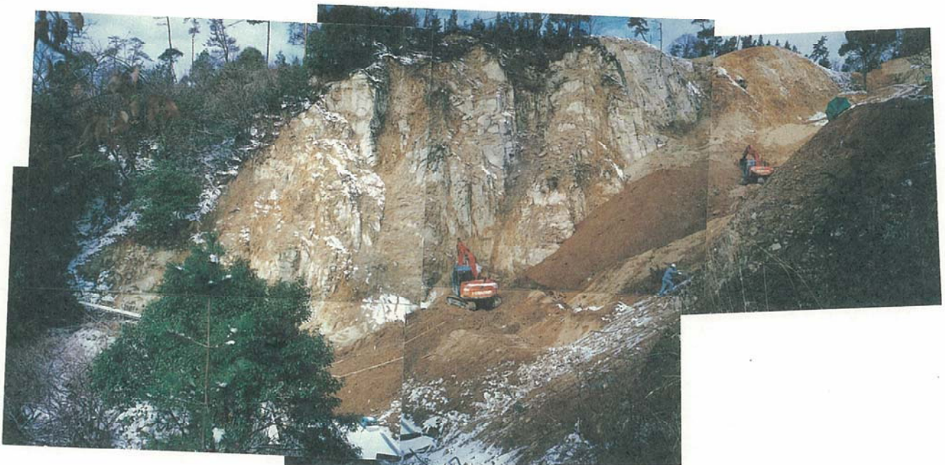
写真-8 西沢における対策工施工状況。斜面の凹凸を整形するとともに、谷止工背面の埋戻し土を整形しているところ。
