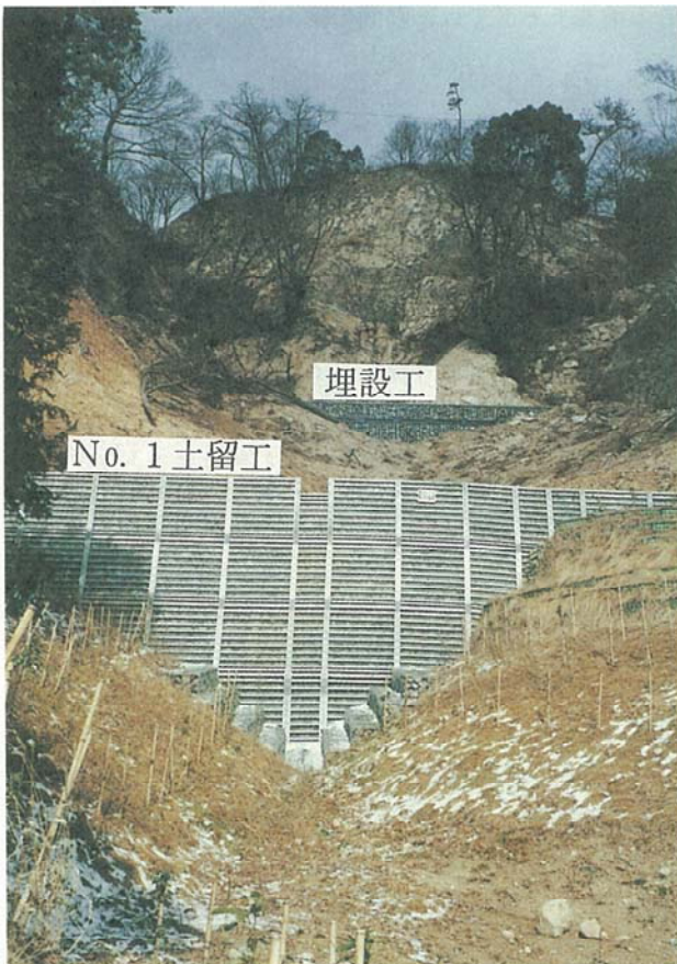
写真-7 東沢におけるNo. 1土留工完成状況。 Photo 7. Completion of Check Dam No. 1 in Higashisawa.
