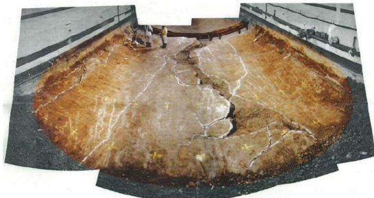
(b)破壊した既設インバートの状況 写真1 破壊した既設インバートの状況 22)
