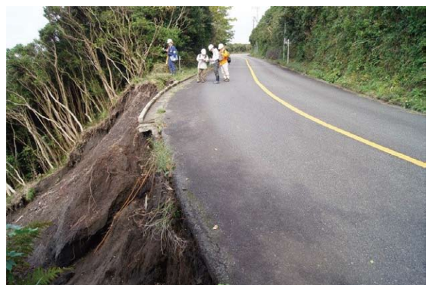
写真-6 道路下方の表層崩壊 (⑥地点) Photo 6 Slope collapse beneath the road (Site ⑥) 道路の流水が曲線部から斜面へ流れ出て、表層崩壊が発生している
