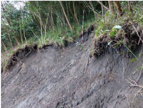
写真-8 崩壊地頭部の状況 Photo 8 Head of collapsed area
